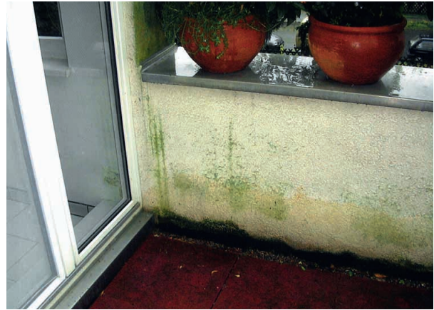
Algenbildung an der Terrassenbegrenzungswand wegen eines mangelhaften Anstriches ohne ausreichende Hydrophobierung und darunter liegendem stark saugenden Untergrund.
